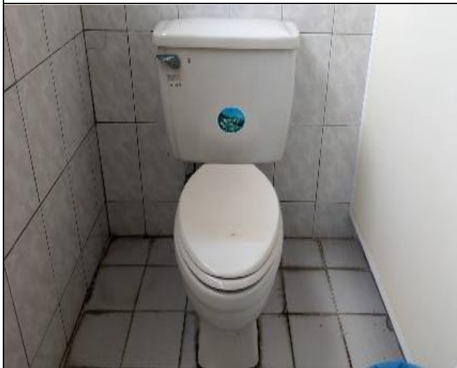
圖說：坐式馬桶破損龜裂，有安全疑慮。
