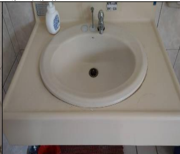
圖說：洗手台漏水，且高度太低。
