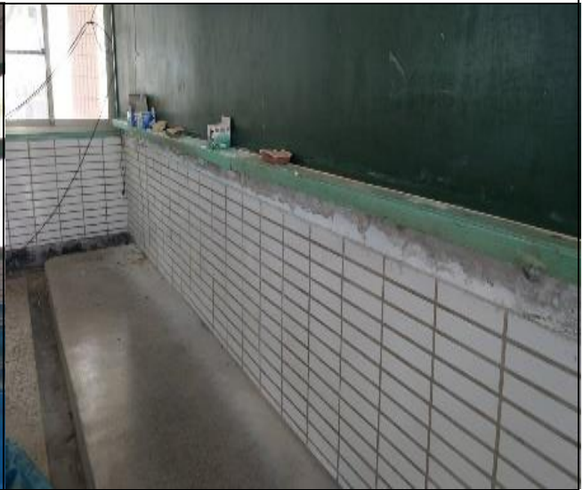
圖說：地板牆面整修破損，造成安全隱憂。
