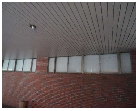
概要說明：弘學樓周邊牆面改善
